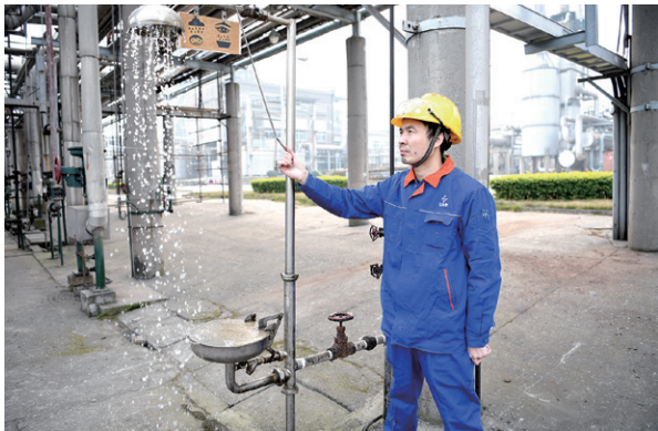
12. 罗显文检查装置现场的洗眼器
